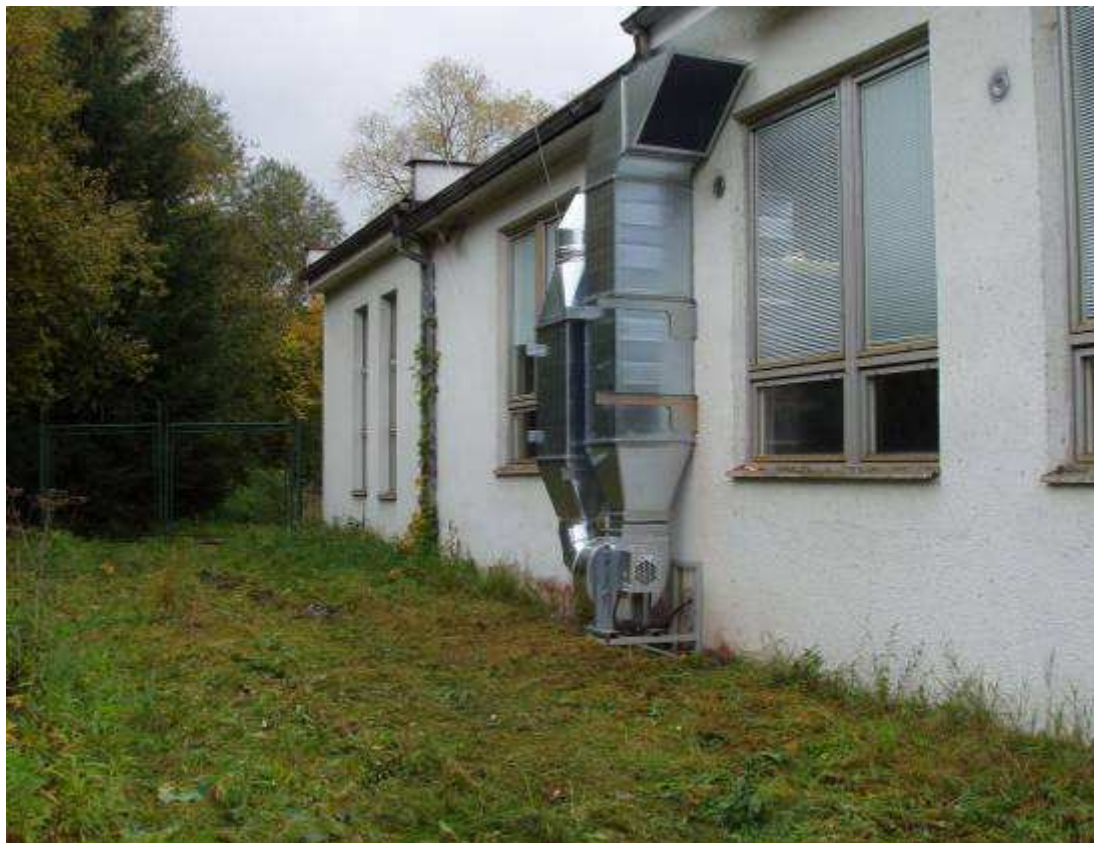
Klimatizace - větrací zařízení obrobny
